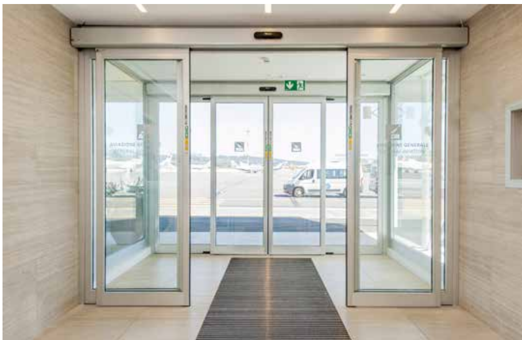
Bussola scorrevole automatica Ponzi TOS con porte automatiche certificate idonee a via di fuga, con zerbino tecnico Ponzi Tire, realizzato con strisce di alluminio e mescola di gomma
